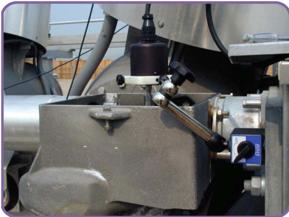
Figura 27. Transductor Rotacional en un interruptor Alstom HE 1014
