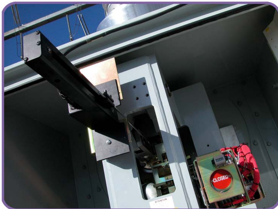
Figura 33. Transductor Lineal en un interruptor Mitsubishi 500-SFMT
